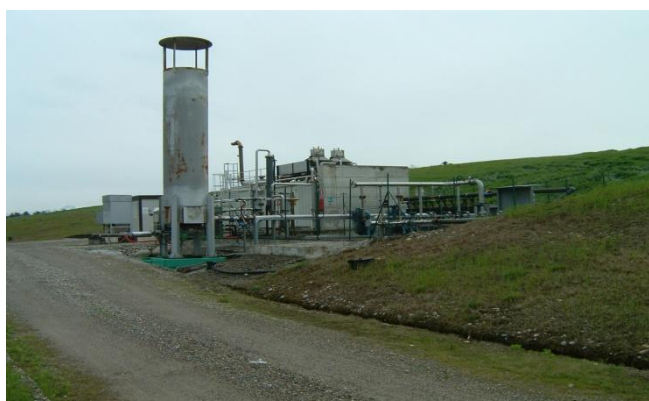
Impianto di produzione di energia elettrica (2007)
